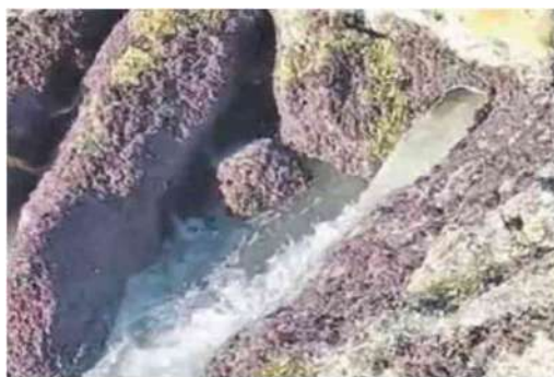
Alivio de fecales por la tubería de la Praia do Porto.
